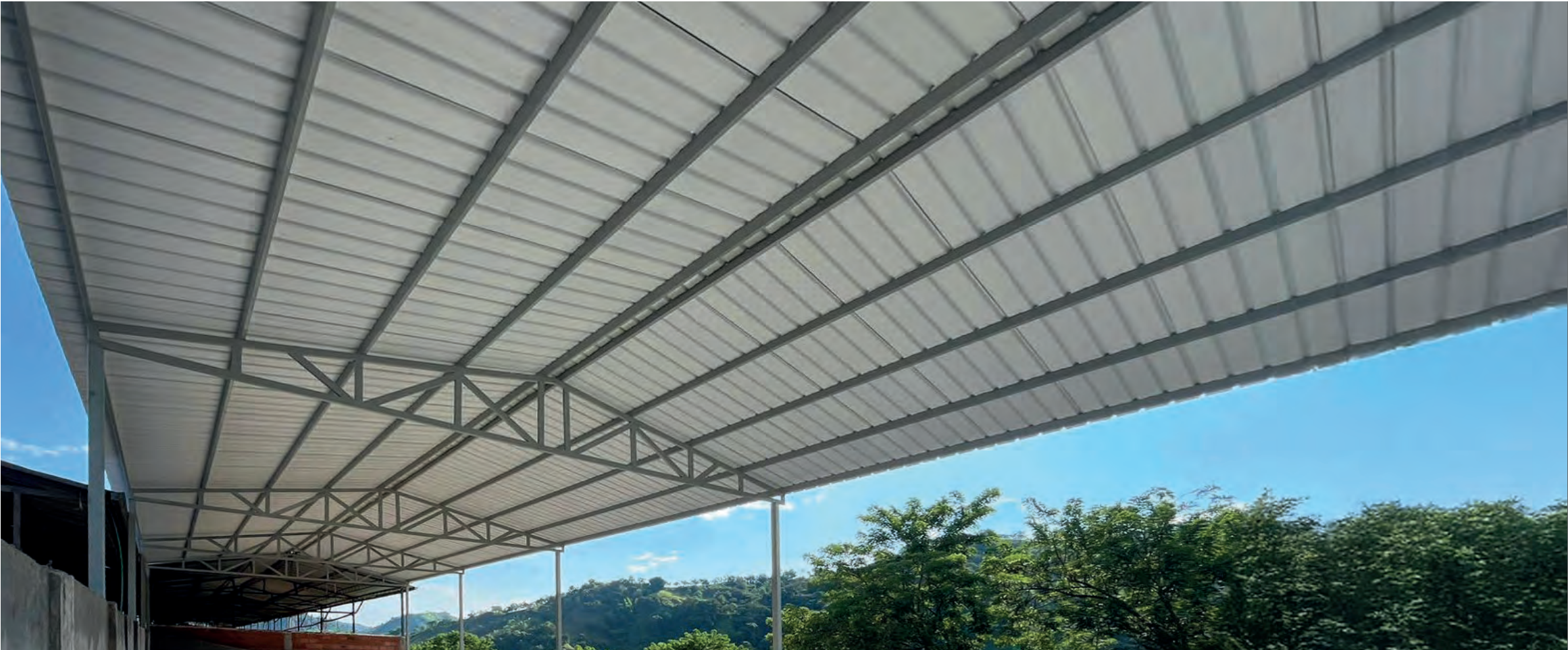
Caja de compensación Combarranquilla, Ecoroof 51 verde, Construcciones Walex, Colombia
