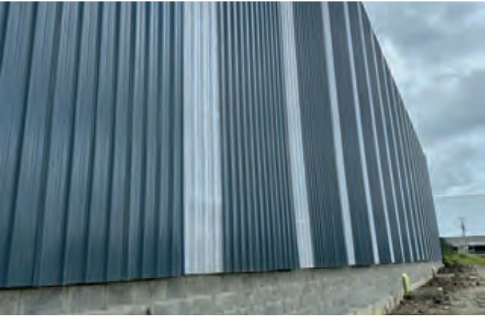
Centro logístico Celpa, Ekorooft , Colombia
